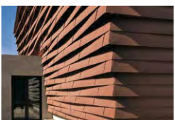
Fitness Center, Sesto Fiorentino, I Studio architetto Fabio Capanni, Florence Idroflorence S.r.l., Badia a Settimo Scandicci (FL) TECU® Classic
